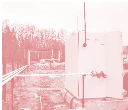
Рис. 7.12. Смесительная установка фирмы FAS в коттеджном поселке выполняет функции резерв- ного источника газа
