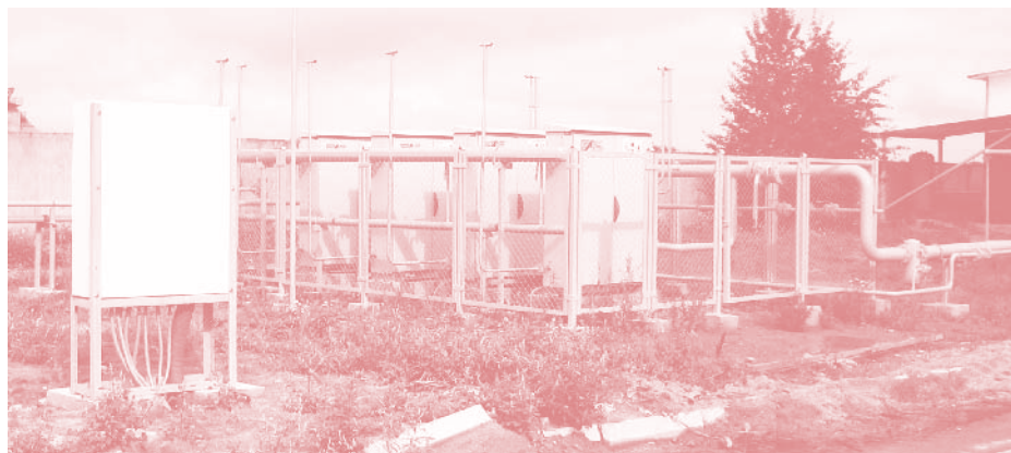
Рисунок 7.1. Парк испарительных агрегатов обеспечивает газом сушильное технологическое оборудование мощностью более 10 МВт
