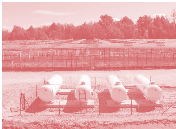
Рис. 4.5. Резервуарный парк надземного размещения
